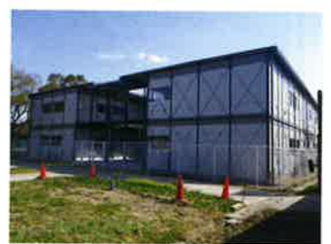
社会福祉法人華福社会大島南保育園 改築工事 設計者：軽尾建築設計事務所 完成予定：2013年12月 構造・規模：RC造・3F・1455.76㎡
