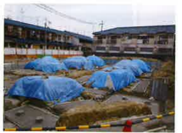
社会福祉法人聖森会たちばな保育園 改築工事 設計者：柳企画設計社 完成予定：2013年11月 構造・規模：RC造・2F・1186.52㎡
